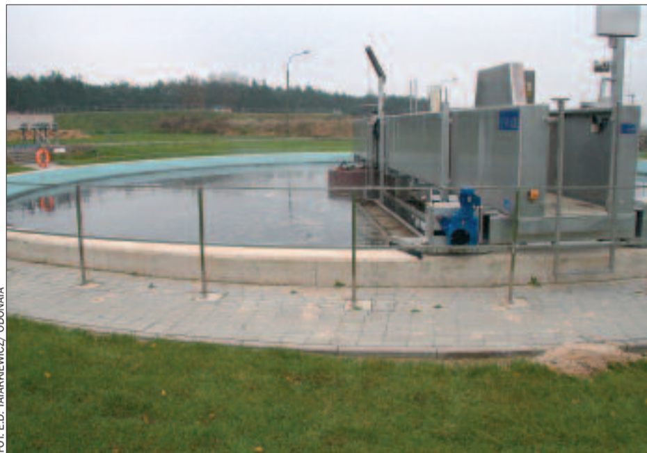
Oczyszczalnie ścieków (jak ta na zdjęciu w Baranowie, gmina Kępno) pozwolą ochronić cenną przyrodę.
