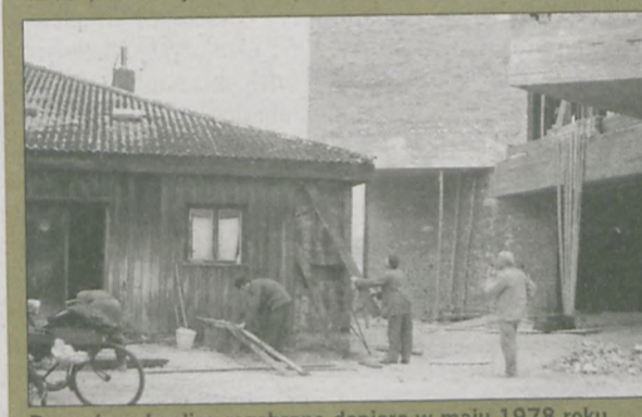
Drewnianą kaplicę rozebrano dopiero w maju 1978 roku. W miejscu, w którym stała w projekcie przewidziane były schody do kościoła
