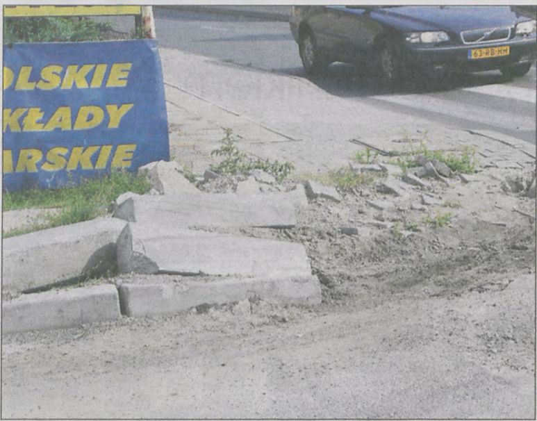
Zniszczony chodnik na skrzyżowaniu dwóch ulic
