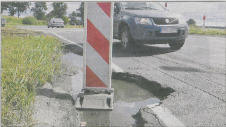
To bardzo niebezpieczne miejsce
