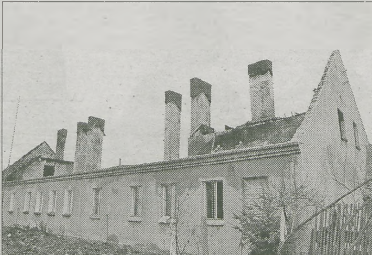
Ogień strawił dach zabytkowego budynku. Mieszkańcy musieli się wyprowadzić
