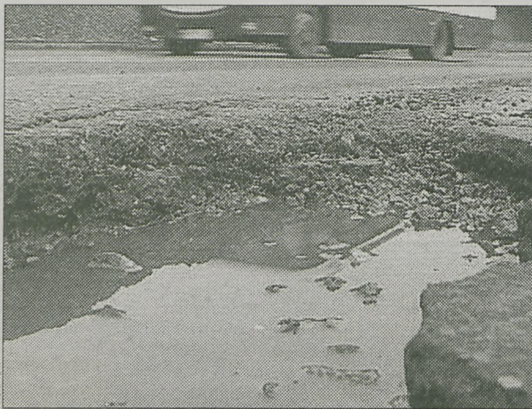
Na takiej dziurze można zerwać zawieszenie
