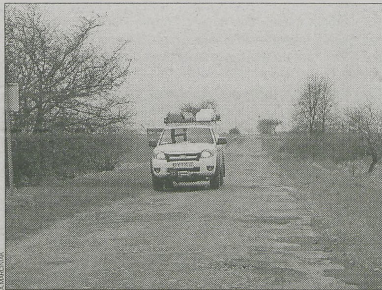
Część drogi nadal jest w fatalnym stanie
