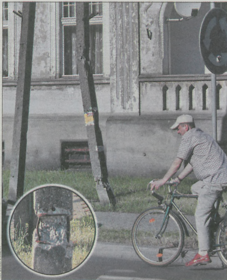
Odnoga słupa jest w dwóch miejscach skruszona – wychodzą z niej pręty
