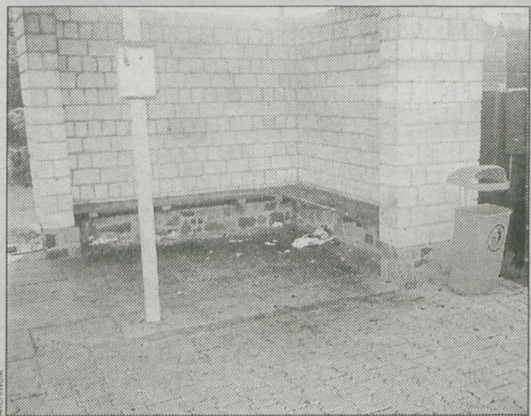
To miejsce bywa zaśmiecanie i niszczone
