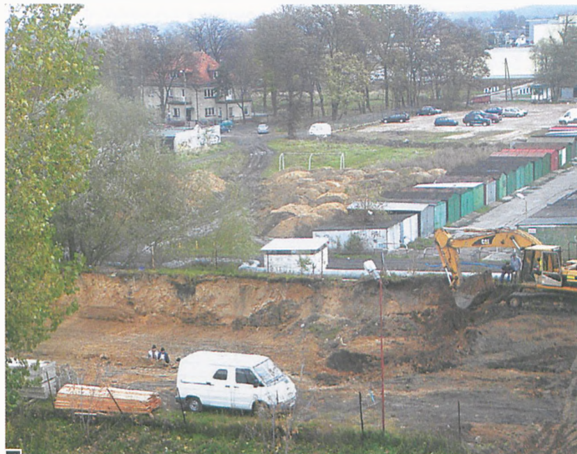
Wykop pod nowy blok przy ul. Sikorskiego. W głębi – teren, gdzie staną kolejne dwa budynki fot. Paweł Jankowiak
