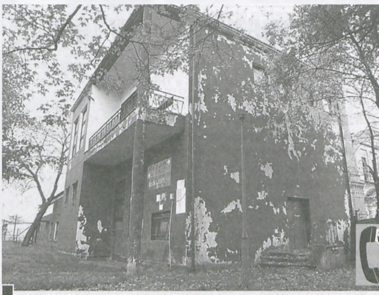
Ośrodek Kultury przy ul. Armii Poznań od lat popada w ruinę fot. Piotr P. Ruszkowski
