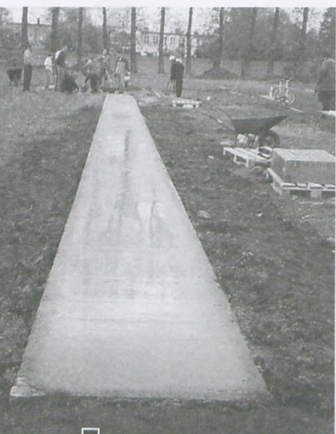
Wybudowana zjednoczonym wysiłkiem nowa bieżnia do skoków w dal w SP 4. fot. Katarzyna Frąckowiak
