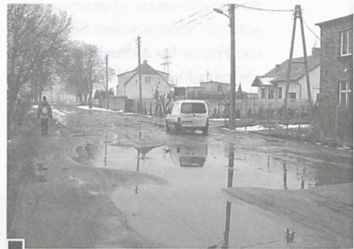
Woda zalegająca na ul. Poznańskiej fot. Magdalena Woźniak
