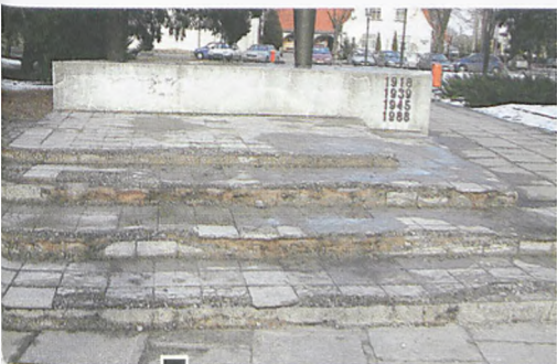
Schody, jak widać, posadowiono na piachu fot. Hanna Siatka
