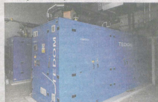
Kogenerator do produkcji energii elektrycznej i energii cieplnej
