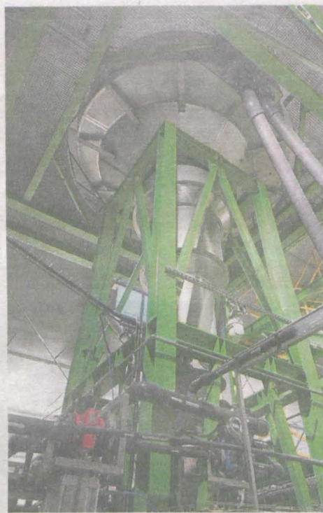
Kolumna krystalizacyjna instalacji fosforu
