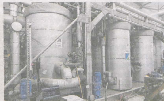
Instalacja termicznej obróbki osadu
