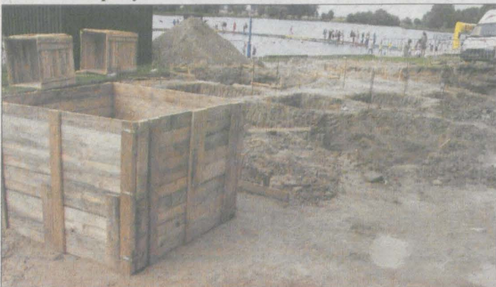
Nad jeziorem rozpoczęły się prace, których efektem będzie postawienie w tym miejscu 60-metrowej zjeżdżalni.
