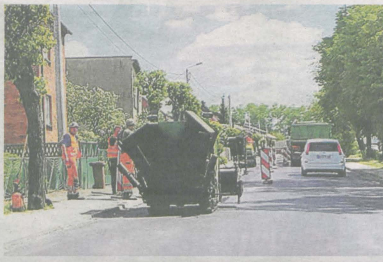
Ulica Dworcowa w Golinie ze względu na ciężki transport, który się nią porusza, wymaga co rusz remontów i napraw
