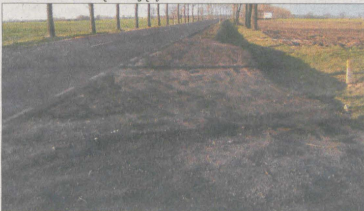
Wysepka na krajowej „11” umożliwiająca swobodny zjazd autobusu i bezpieczne wsiadanie i wysiadanie dzieci uczących się.
