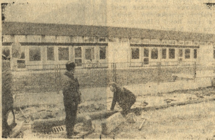
W Ostrowie (Końskie) przy ul. Bardowskiego na początku grudnia oddane zostanie do użytku nowe przedszkole. Obiekt wybudowano w półrocznym cyklu przy dużym udziale czynów społecznych podjętych przez ostrowian w roku 40-lecia PRL.
