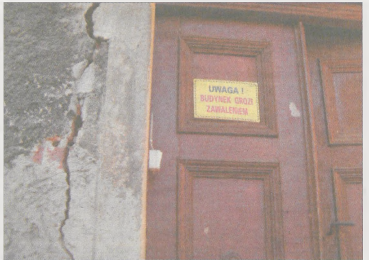
Zawalenie stropu przy ul. Górki 1
