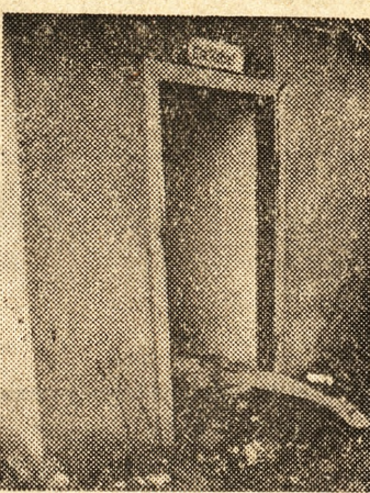
Tak wygląda ubikacja, a niewiele lepszy jest stan innych budynków na stacji PKP Poznań — Podolany. Kto i kiedy zrobi tu porządek? Fot. — R. Królak
