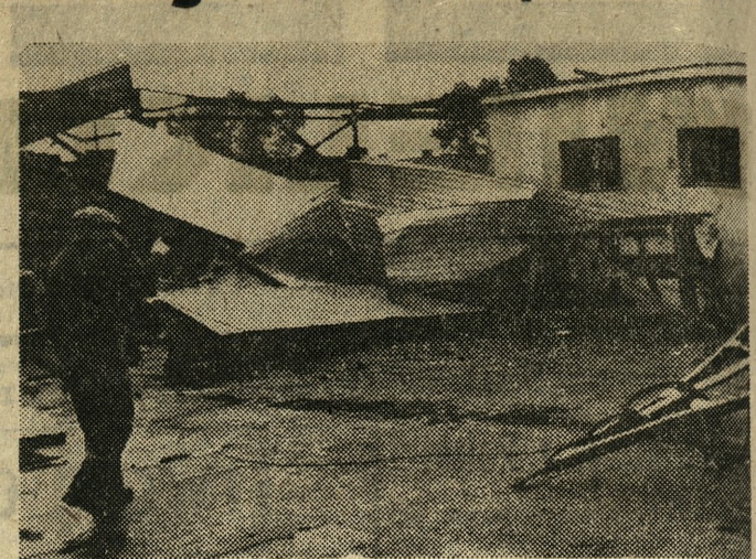
Zerwany dach z budynku GS w Dopiewie.
