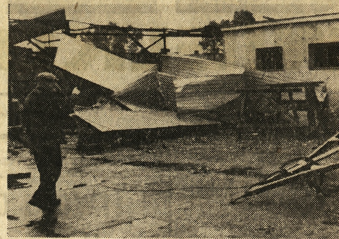
Zerwany dach z budynku GS w Dopiewie.
