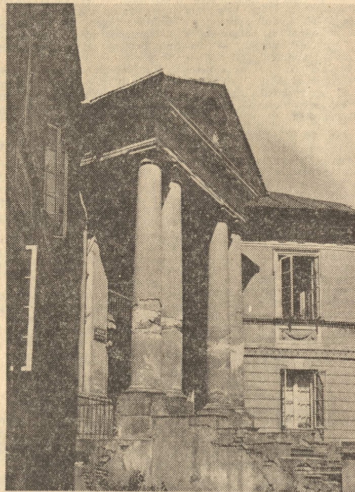
Fragment elewacji frontowej pałacu w Dobrzycy, nadgryzionej przez „zęb czasu”.
