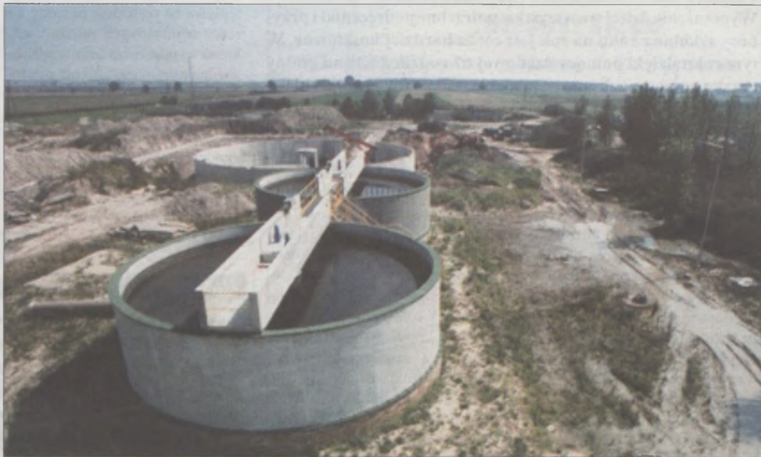
Miejska oczyszczalnia ścieków w Chwałkowie
