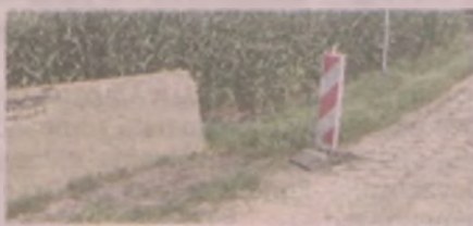
Dziura przy mostku na rzece Lipince jest słabo widoczna, dlatego tym bardziej niebezpieczna
