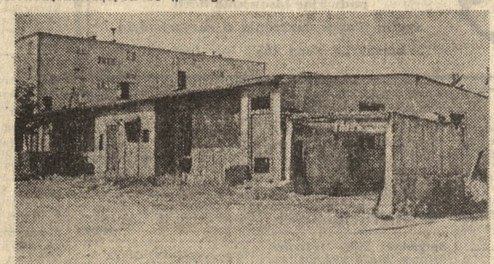
Tak oto wyglądają rudery, widoczne doskonale z ruchliwej ulicy Wojska Polskiego. Na ich rozbiórkę czeka się od wielu lat.
