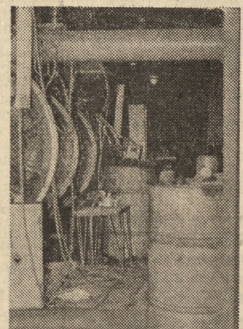
Gdyby ktoś miał wątpliwości to nie magazyn złomu, a wnętrze Pracowni Ogrzewnictwa i Klimatyzacji PP. Fot. (2) — M. Różański
