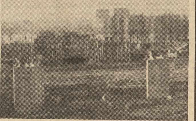
Pierwsze mrozy nie osłabiły tempa prac przy budowie Trasy Łazienkowskiej w Warszawie. Na szeregu odcinków nowego szlaku komunikacyjnego wykonawstwo wyprzedza harmonogramy. Dotyczy to także rejonu budowy nowego mostu. Na zdjęciu: filary mostu na przyczółku praskim. W głębi widoczne filary wznoszone w nurcie Wisły. CAF — fot. Rosiak
