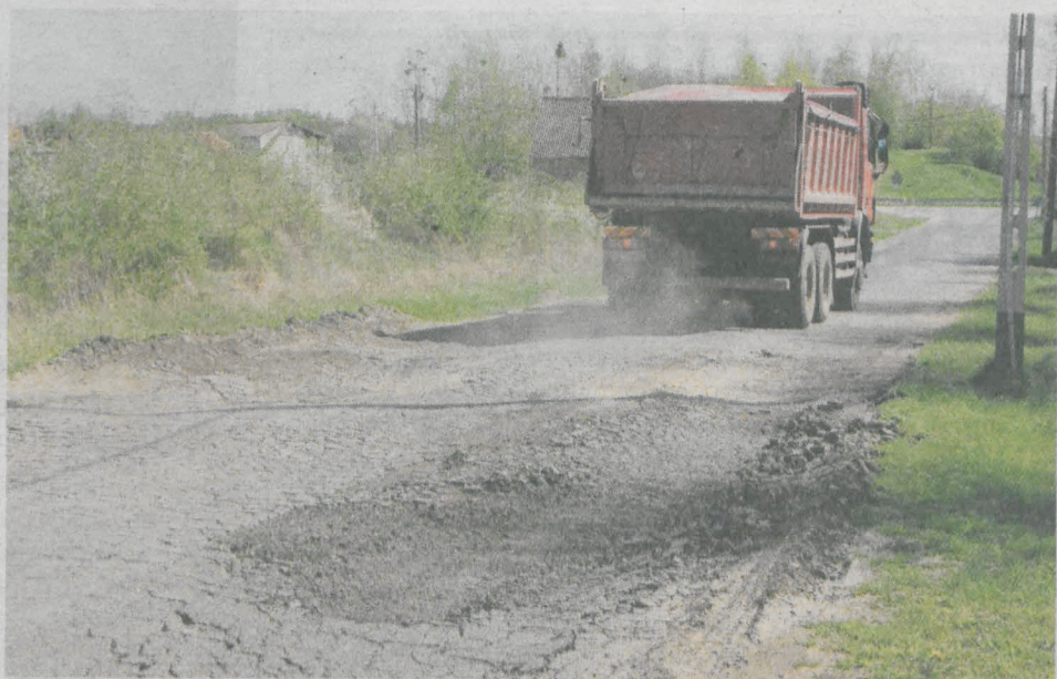
Ulica Leśna w Cielczy prowadzi do kopalni piasku. Ciężarówki transportujące surowiec na budowę łącznika w Jarocinie zniszczyły jej nawierzchnię
