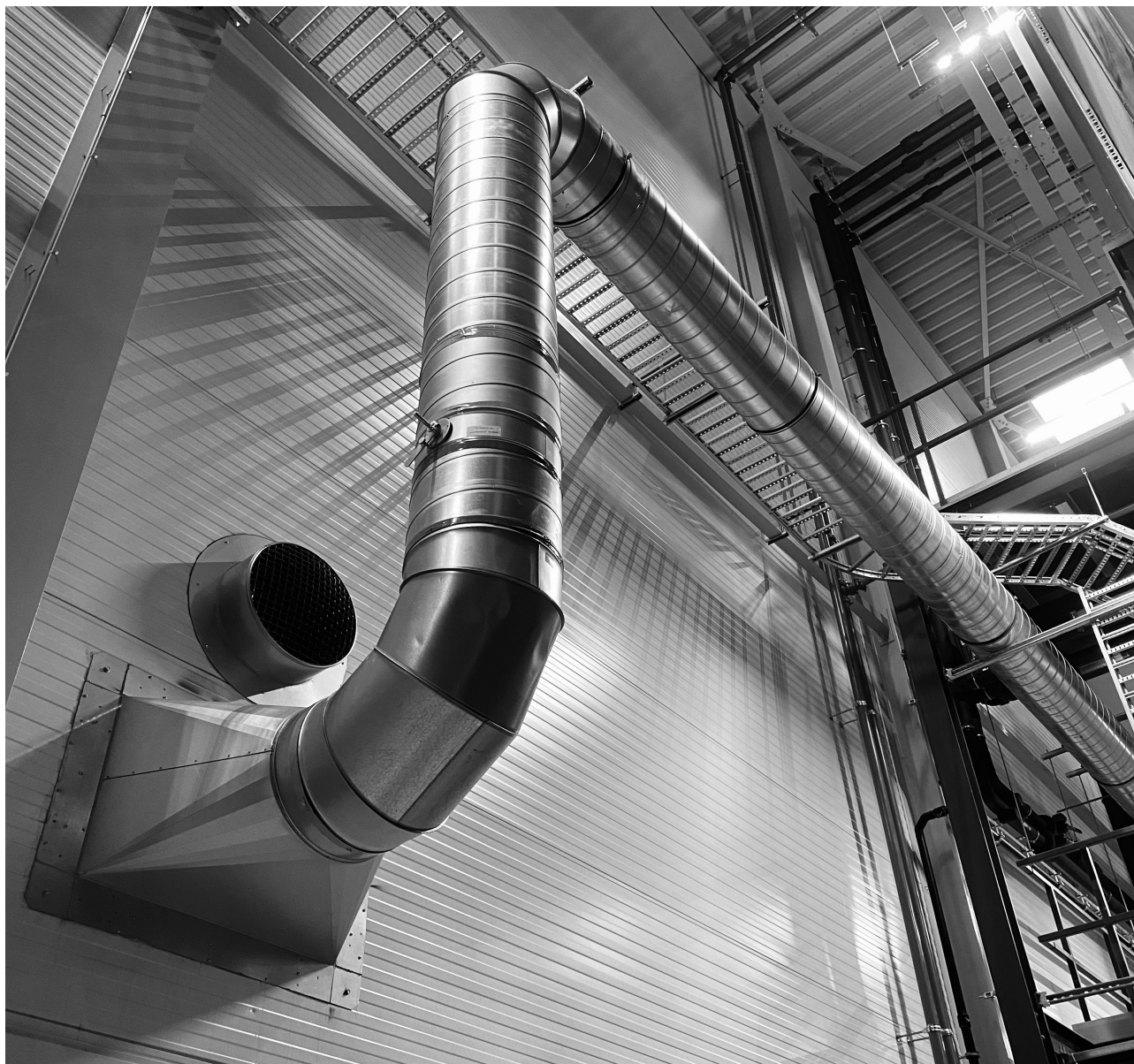
Ilustracja 8 Przewód wentylacyjny w hali wysokiego składowania.
