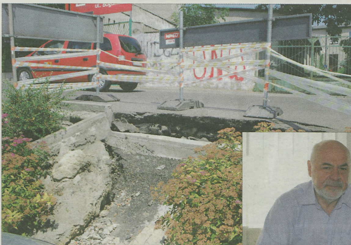
Fragment uszkodzonej nawierzchni drogi na ulicy Tureckiej w Uniejowie.
