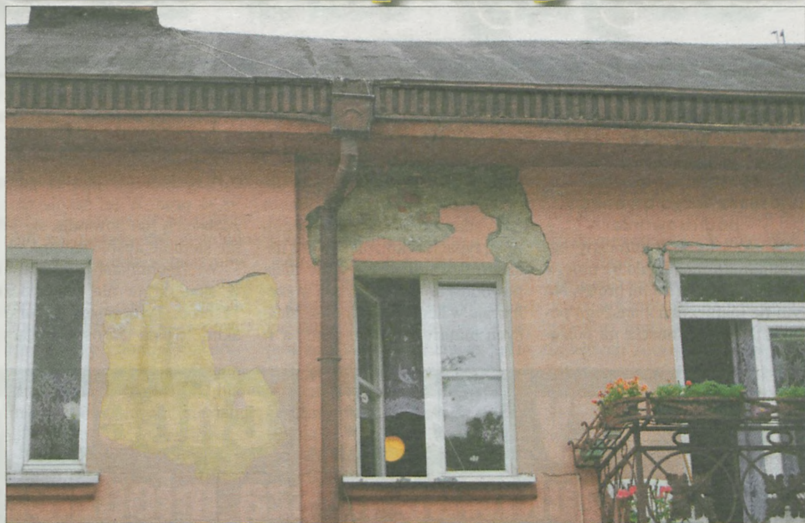
Front nieremontowanego od ponad czterdziestu lat domu przy Placu Sienkiewicza 11.
