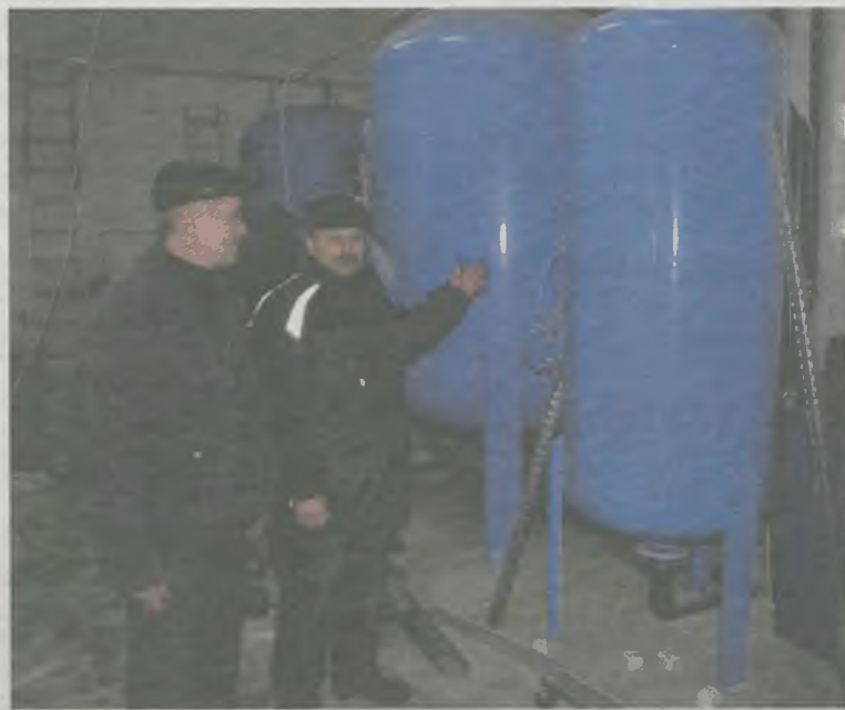
Krzysztof Kucharski prezentuje nowe urządzenia montowane w stacji uzdatniania wody w Długiej Wsi.
