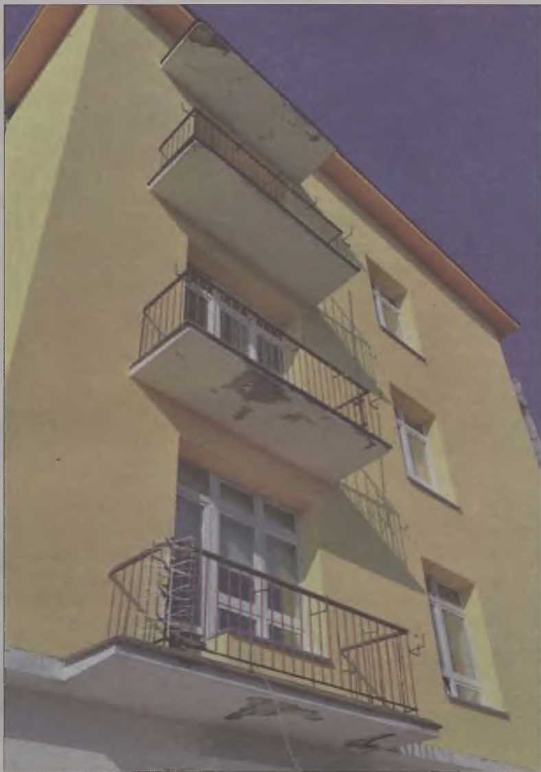
A to jeszcze inna odsłona termomodernizacji szpitala, czyli balkony, które świecą plamami odpadającego tynku.
