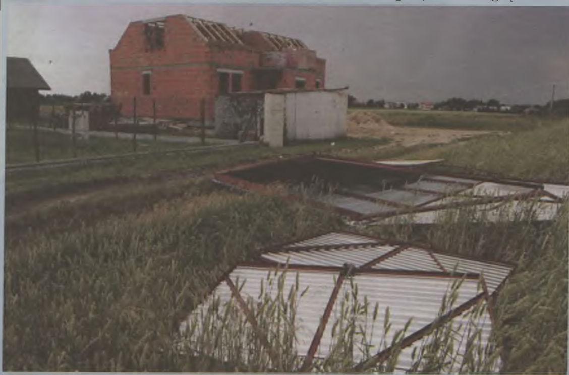
Kilka metrów w powietrzu przeleciał też blaszany garaż postawiony tymczasowo przy budowie jednego z domów w okolicach ulicy Leśnej.
