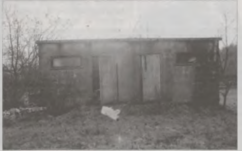
Budynek gospodarczy, podobnie jak szkolny, wymaga generalnego remontu.
