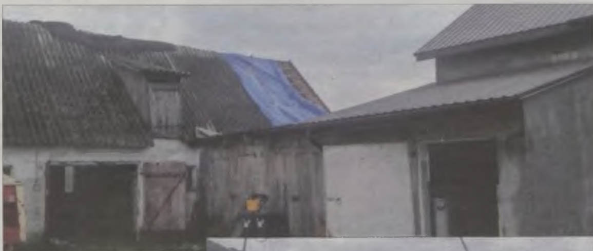
Uszkodzone dachy, zabezpieczano plandekami.
