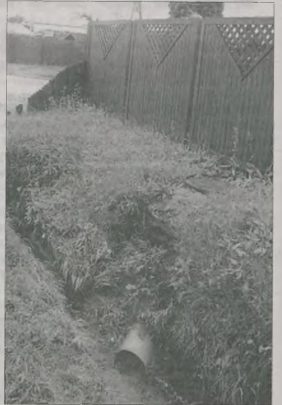
Według właścicielki posesji w Piętnie woda płynąca z wylotów zamontowanych przez firmę zalewa jej dom. Jej wątpliwości budzi wielkość rur, według pozwolenia mogą one mieć nie więcej niż 20 cm.
