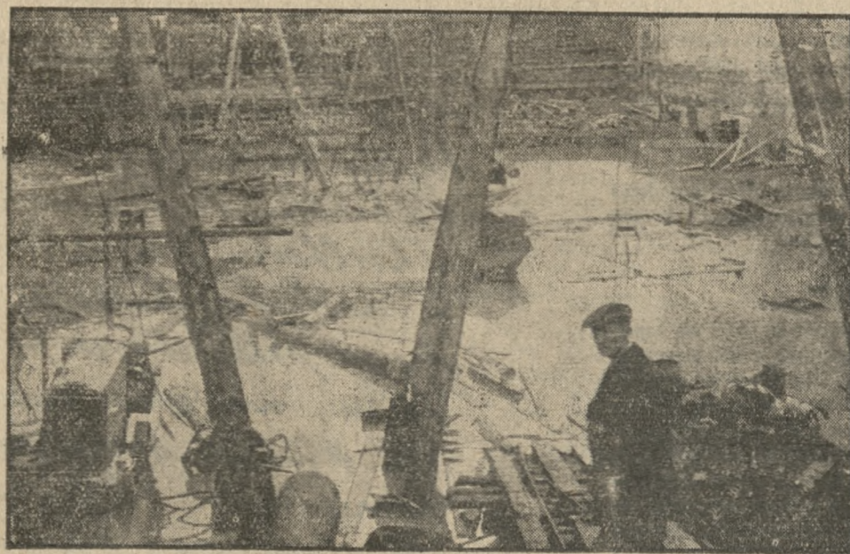
Plac budowlany P. K. O. w Poznaniu pod wodą. (Fot. Fot-Express — Majewski)
