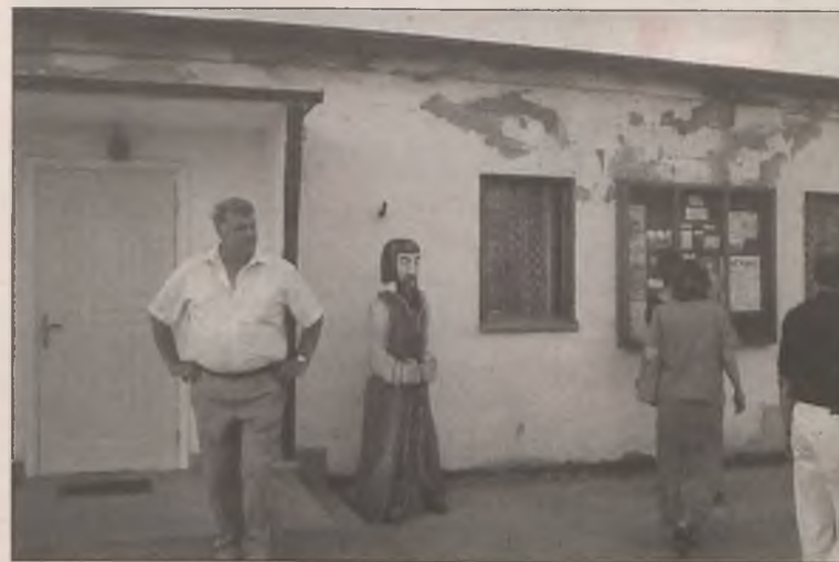
Na fasadzie szatni w Gałowie rozwinął się grzyb.
