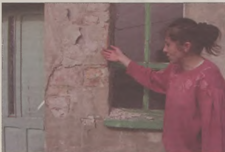
Matka pokrzywdzonego pokazuje uszkodzoną ścianę budynku
