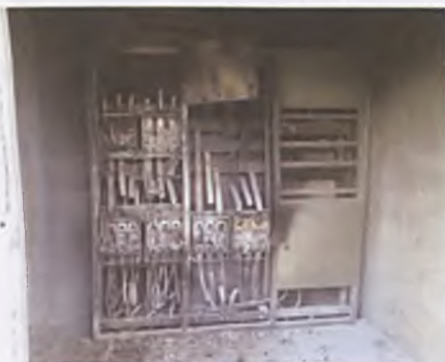
Rozdzielnia elektryczna po pożarze
