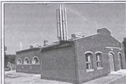
Stacja redukcji gazu zlokalizowana na Czarnokurzu w pobliżu ul. Mokrej jest inwestycją poznańskiej Gazowni, ale jej postawienie było warunkiem podłączenia do sieci gazowej miasta i gminy Mosina.
