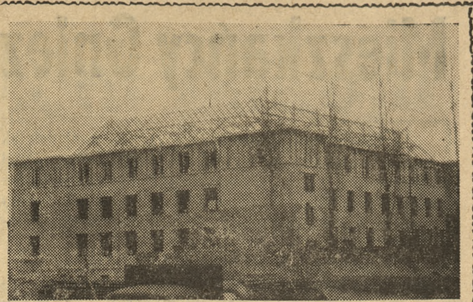
Budynek b. Gimnazjum Bergera przy ul. Strzeleckiej, całkowicie wypalony podczas działań wojennych w 1945 r. znajduje się w końcowym stadium odbudowy, prowadzonej rekami pracowników Społecznego Przedsiębiorstwa Budowlanego. Obecnie trwają roboty tynkarskie dekarskie i blacharskie. Zaplanowany na wrzesień br. termin oddania gmachu do użytku Drukarni Uniwersyteckiej zależy jedynie od przyznania dalszych kredytów przez Ministerstwo Oświaty. (wm)
