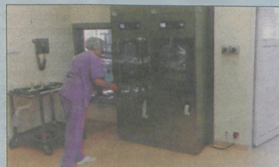
Centralna sterylizatornia to jedno z najnowocześniejszych wyposażonych miejsc
