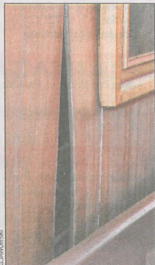
Ściany pękają od ciężaru
