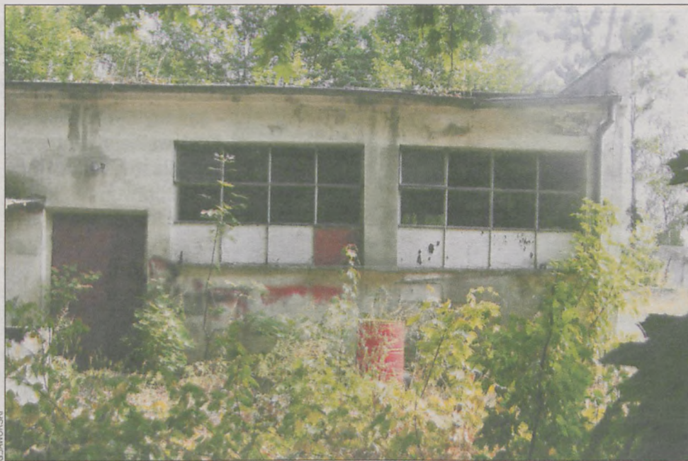
Teren wymaga zdecydowanego uporządkowania
