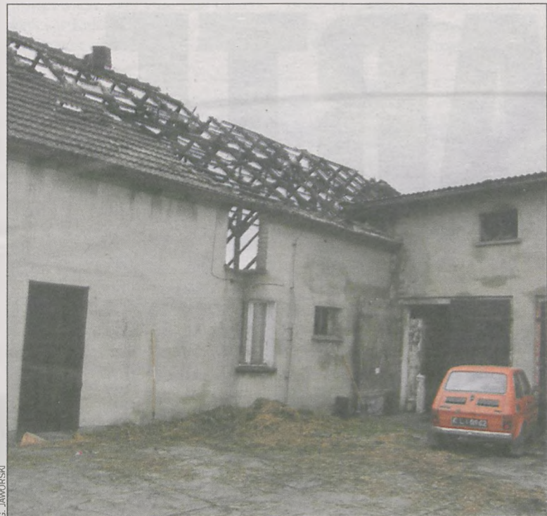
Ściany są bardzo przesiąknięte
