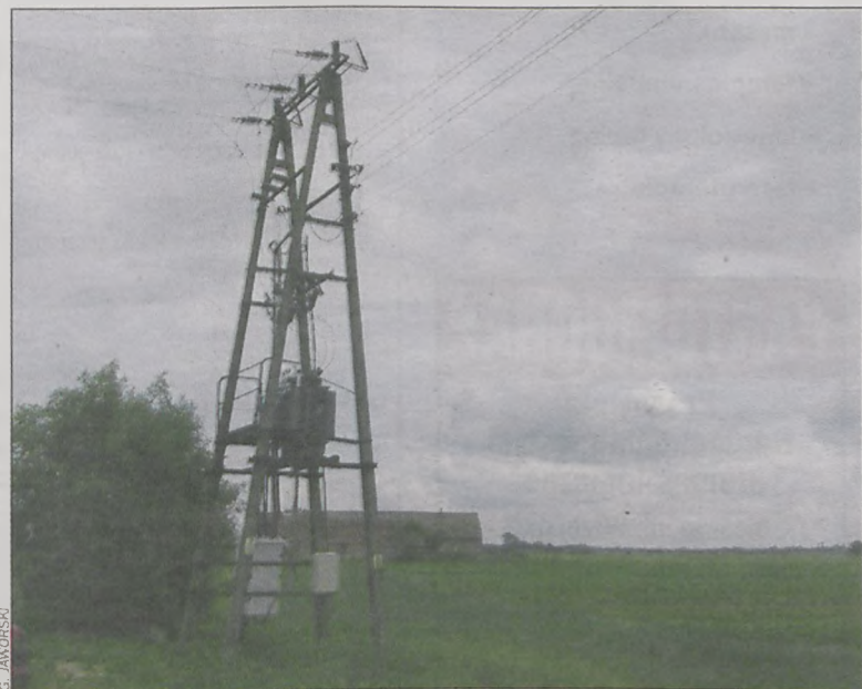
Czy przyczyną uderzenia pioruna był stojący nieopodal transformator?
