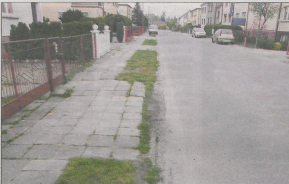
Chodnik wymaga remontu
