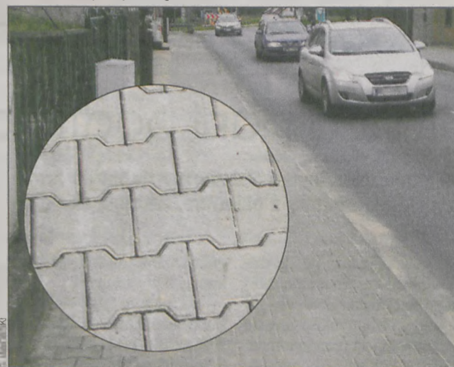
Zakończony odcinek nie wygląda najlepiej, szczeliny nie zostały zasypane piaskiem
