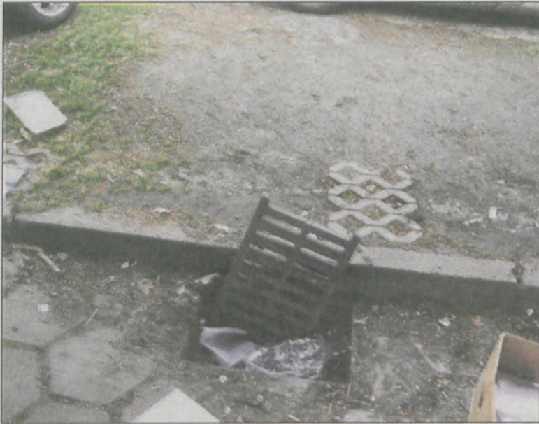
Studzienki nie są w stanie odbierać wody
