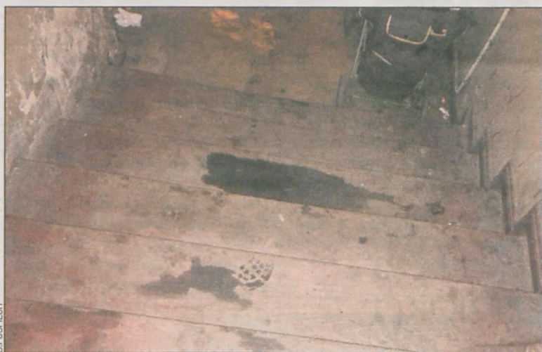
Schody są często zalewane moczem
