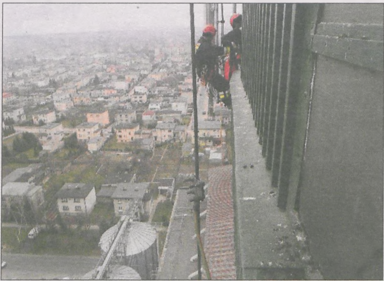
Akcja na wieży elewatora nie należała do bezpiecznych
