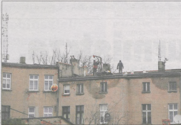
Czy po położeniu dwóch warstw papy dach przestanie przeciekać?
