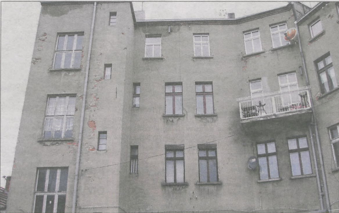
Kamienica od podwórza. Zacieki na ścianie przy dachu widać wyraźnie
