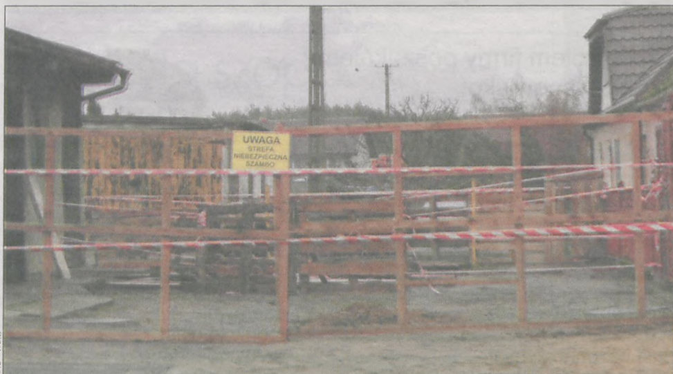
Miejsce wypadku zostało zabezpieczone, odgrodzone i oznakowane
