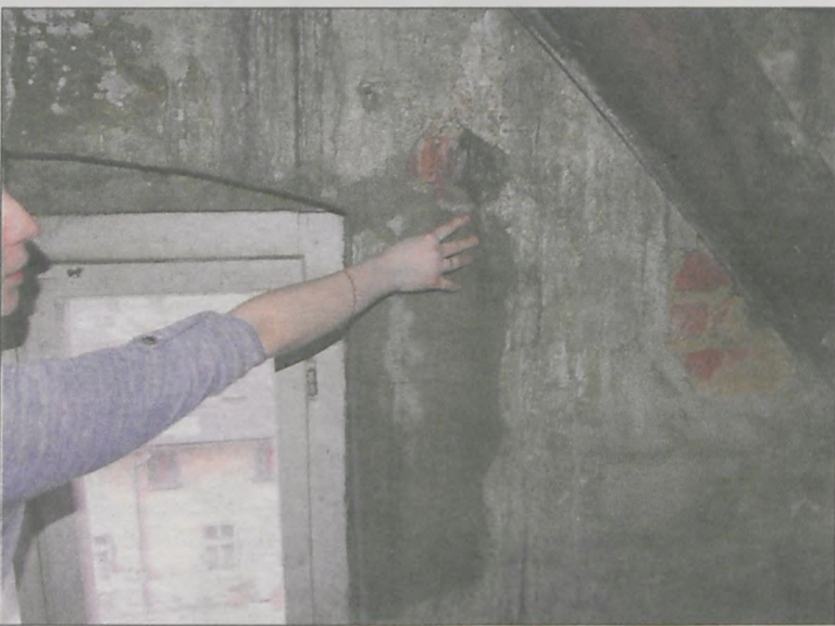
Na strychu woda leci ciurkiem, a zawilgocony tynk odpada
